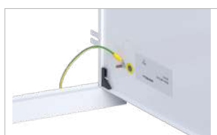
Cable de conexión a toma de tierra
