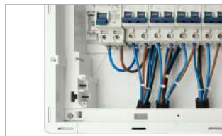
Amplio espacio para el cableado
